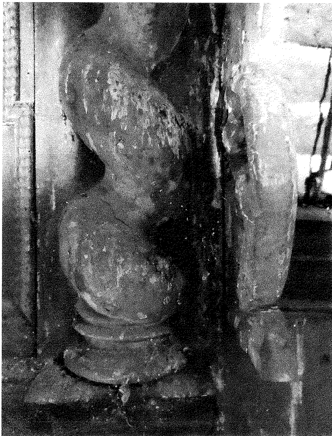
Jedna z kolumn konfesjonu (sierpień 2023). Widoczna gruba warstwa zabrudzeń organicznych.
