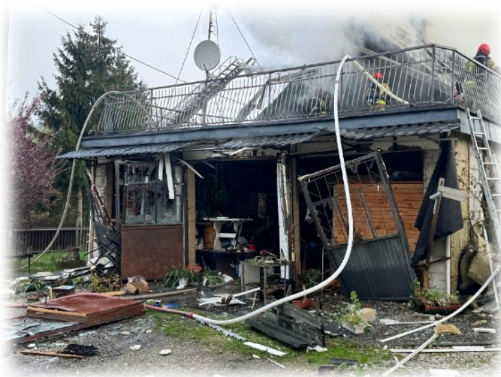
Rysunek 1. Pożar budynku mieszkalnego w miejscowości Jagodnik.
